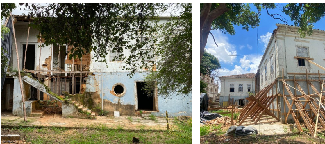
Figura 7: À esquerda, imagem de fachada interna do casarão parcialmente arruinada; à direita, casarão após escoramento, passando por projeto de restauração
