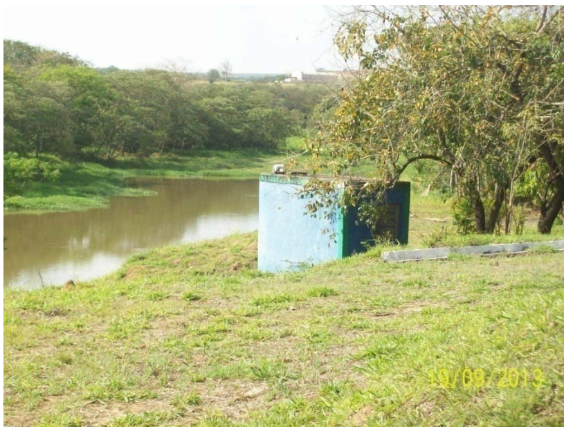
Foto 18 – ETA II - Estação Elevatória de Água Bruta - Ribeirão Água Choca
