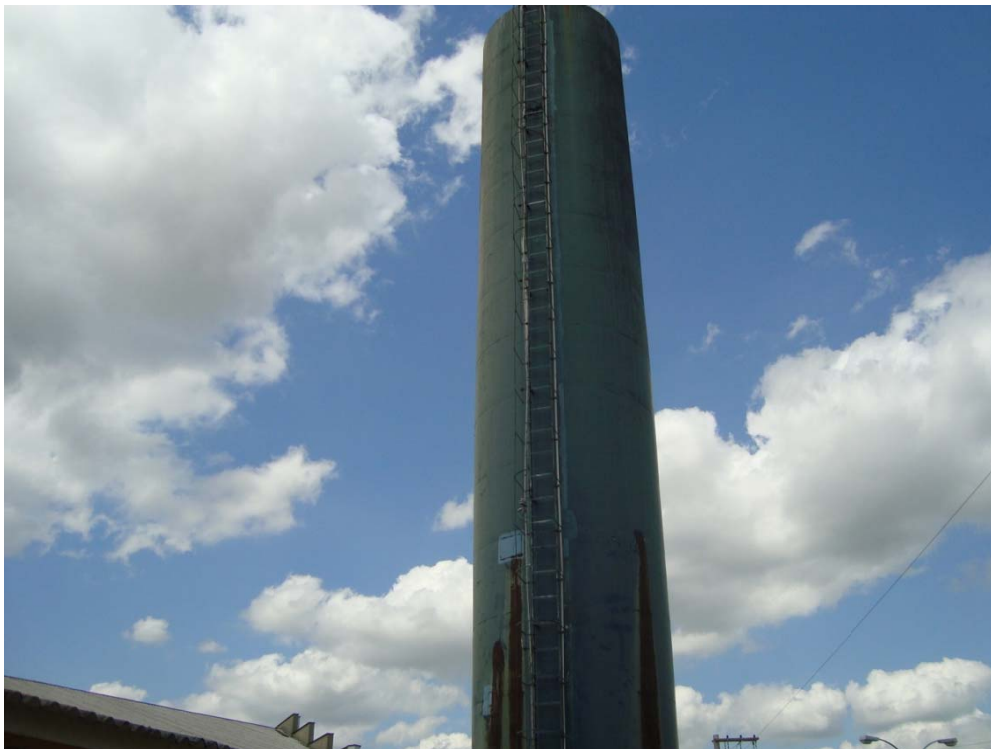
Foto 28 – Reservatório Porto Alegre de 150 m 3 de capacidade.
