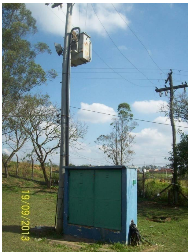
Foto 24 – Entrada de energia da ETA II.
