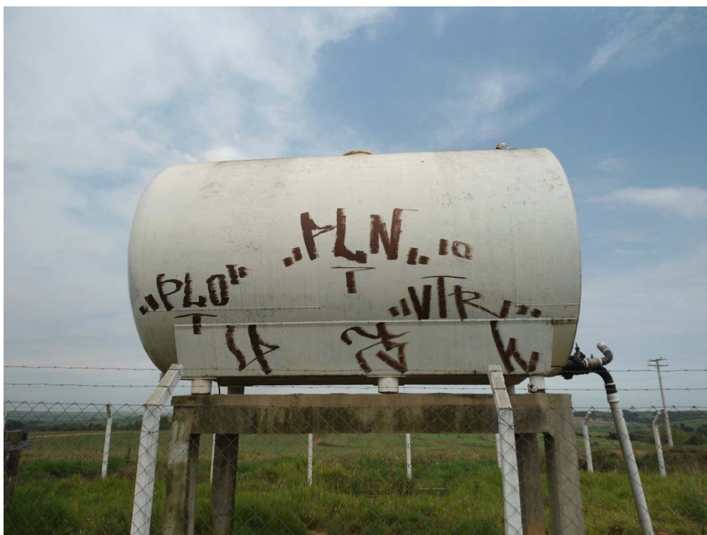
Foto 32 – Reservatório Paineirinhas de de 50m³ de capacidade
