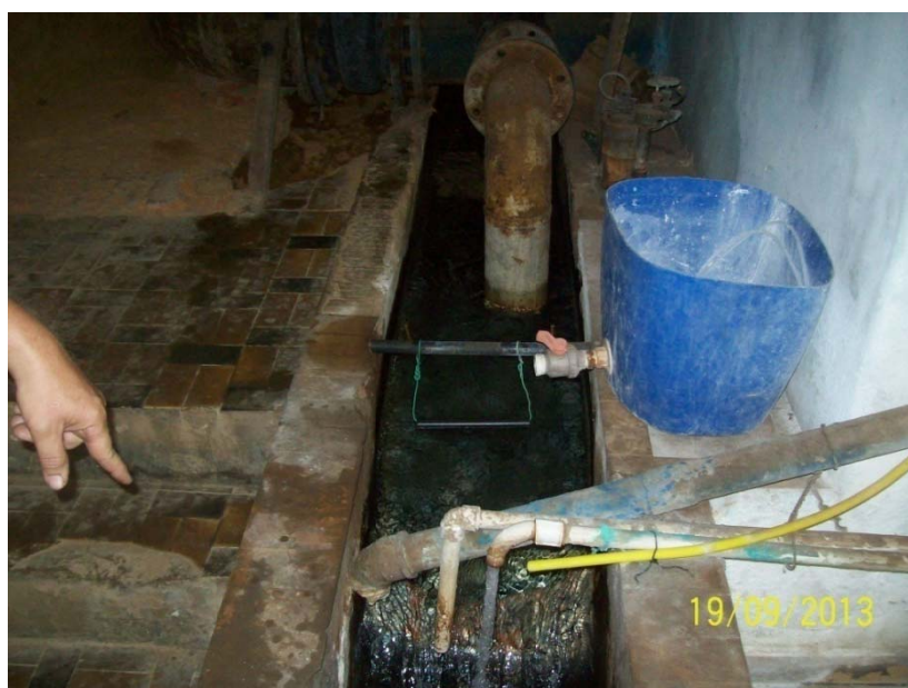
Foto 10 – ETA I – Canal de água tratada - pós-tratamento – local de aplicação de produtos químicos.
