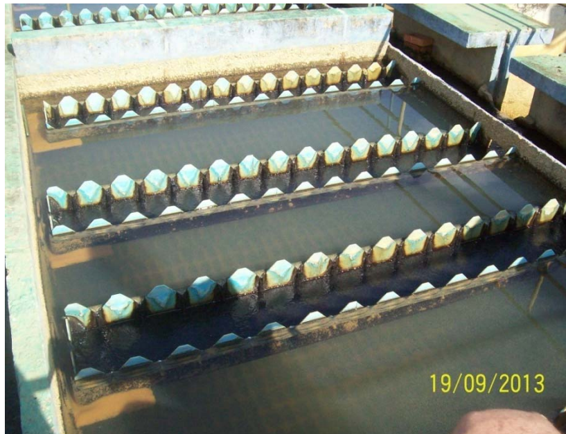
Foto 22 – Decantadores do tipo módulo tubular
