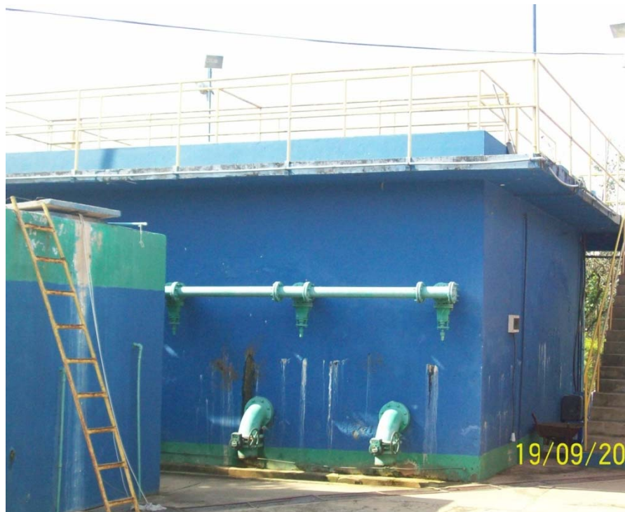
Foto 23 – Vista de um módulo de tratamento – Em detalhe tubulações do sistema de lavagem de filtros
