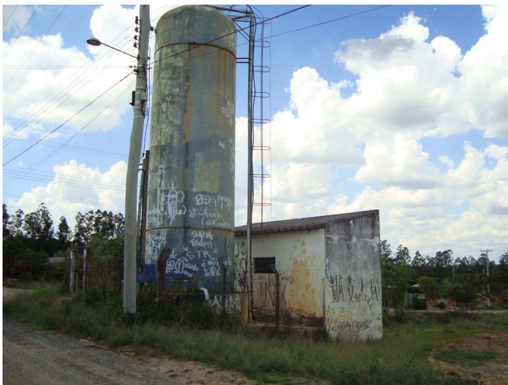
Foto 30 – Reservatório Santa Rita de Cássia de 70m 3 de capacidade em más condições de conservação .
