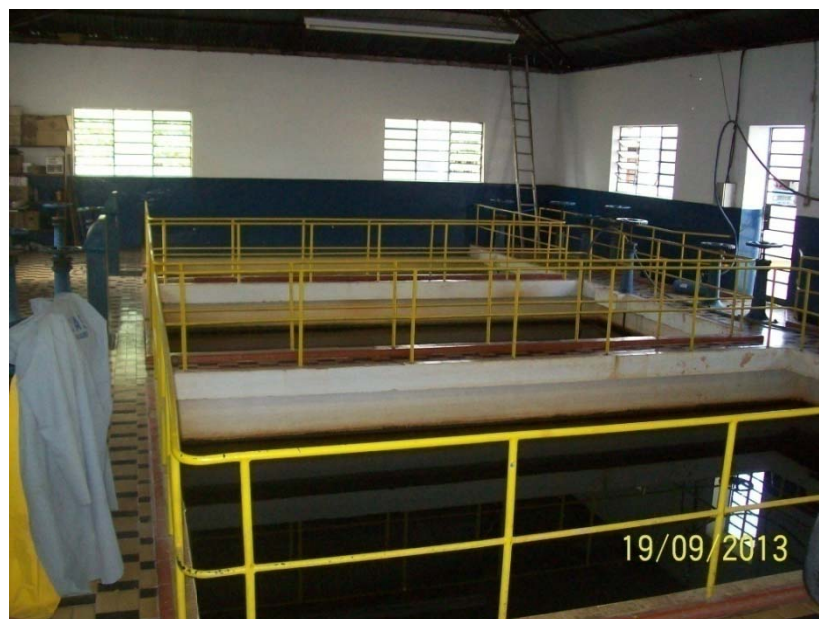
Foto 7 – Vista dos três filtros no interior da edificação
