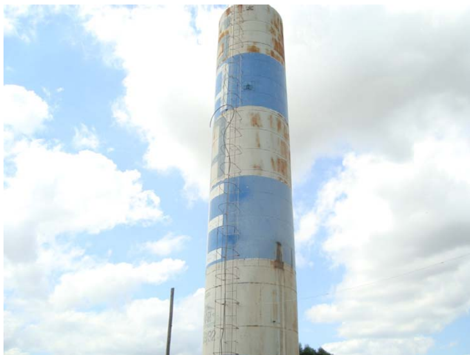
Foto 31 – Reservatório Bosque dos Pinheiros de 150 m 3 de capacidade apresentando pontos de oxidação
