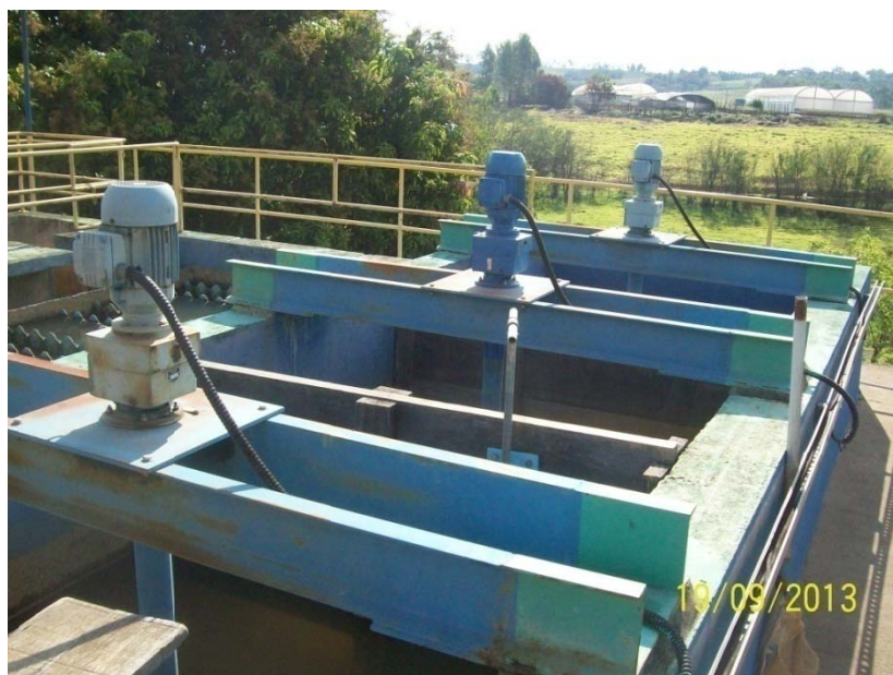
Foto 21 – ETA II - Vista dos Floculadores
