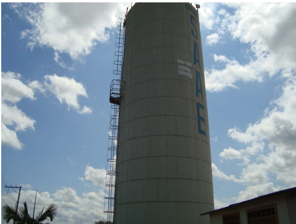
Foto 29 – Reservatório Porto Alegre de 500 m 3 de capacidade.
