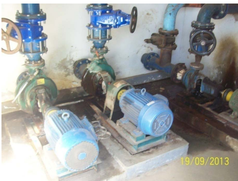
Foto 27 – Elevatória de água tratada da ETA II – Sistema Grand Tour - dois conjuntos a esquerda e EEAT Caraça (conjunto à esquerda)
