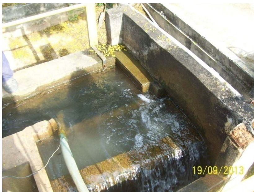
Foto 2 – ETA I - Caixa de chegada de água bruta - Córrego Engenho Velho e Barragem do Milhã
