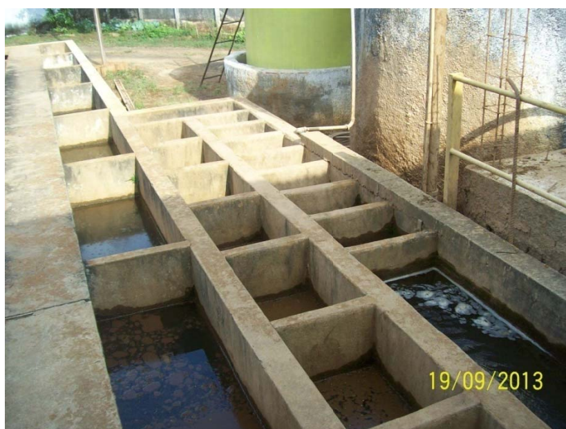
Foto 4 – ETA I - Floculador hidráulico de chicanas
