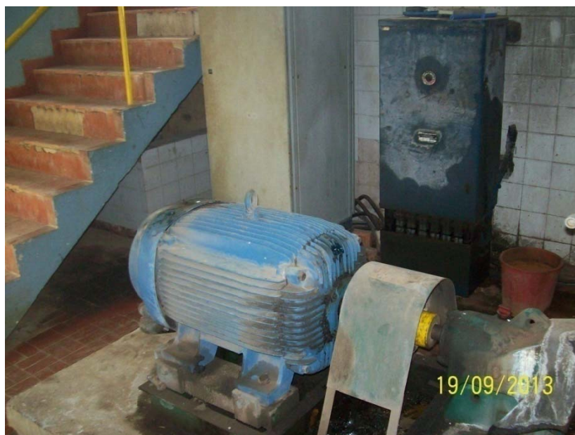
Foto 11 – ETA I - Conjunto de recalque para o Centro de Reservação Central.
