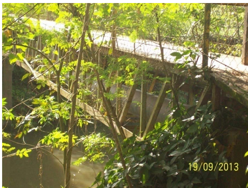
Foto 12 – ETA I - Linha de recalque de 250mm – Trecho ETA I - Centro de Reservação Central.
