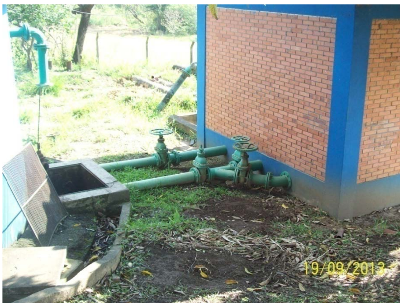
Foto 26 – Vista da elevatória traseira . Em detalhe tubulações de interligação entre o reservatório e os conjuntos de recalque.
